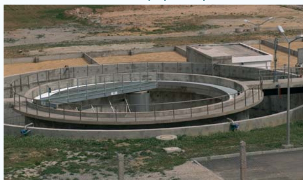
Mrezgua capacité : 2500 m 3 /jour Treatment capacity:2500 m 3 /day
