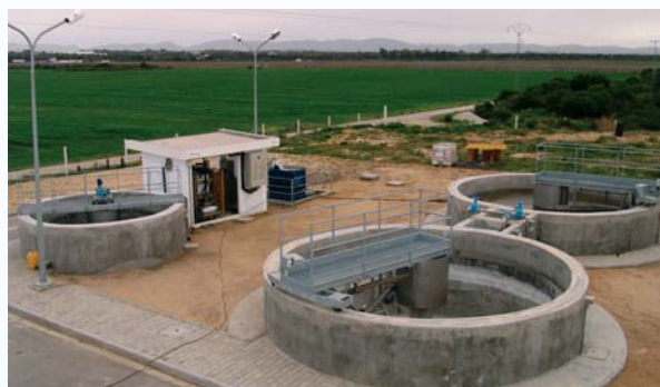
Mrissa capacité : 200 m 3 /jour Treatment capacity:200 m 3 /day
