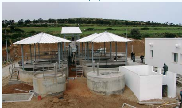
Korbus capacité : 600 m 3 /jour Treatment capacity:600 m 3 /day
