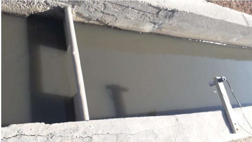
Figure 11 : Débitmètre eau traitée
