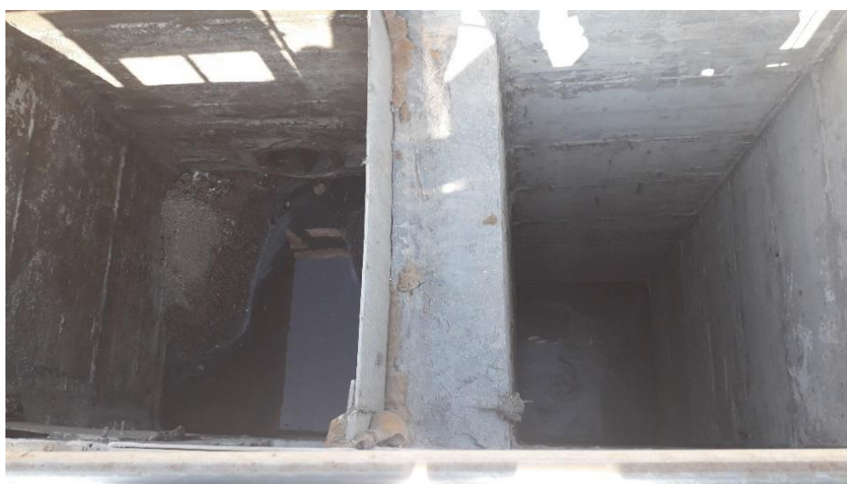
Figure 8 : Bâche d'arrivée avec déversoir, nouveau prétraitement
