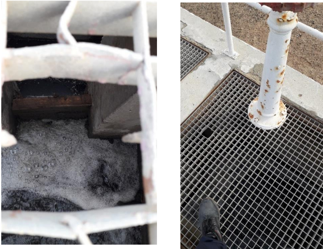
Figure 10 : Déversoir de bypass des eaux prétraitées et vanne d'isolement sur la sortie vers biologique
