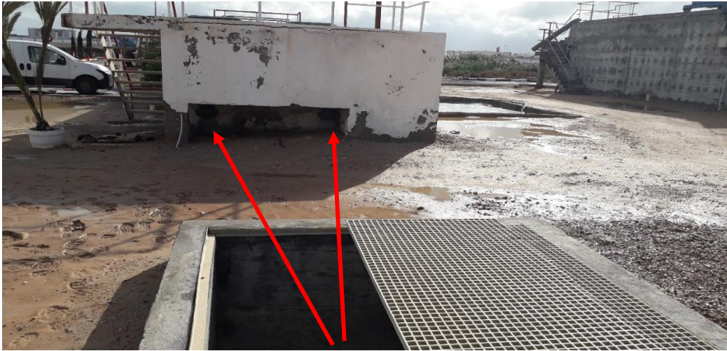
Figure 9 : Alimentations de l'ancien prétraitement
