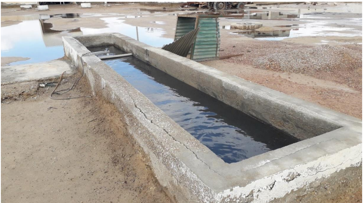
Figure 14 : Canal de comptage eau traitée noyé après évènement pluvieux
