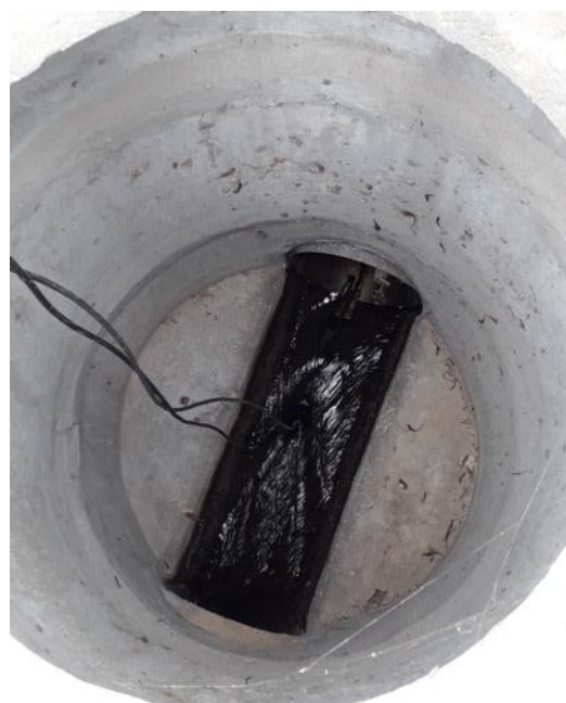
Figure 19 : Prise de mesure en regard débitmètre EE
