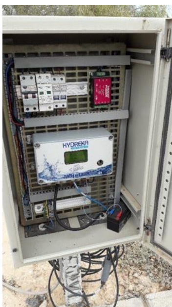
Figure 18 : Armoire débitmètre eau traitée
