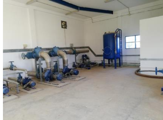
Figure 10 : Station de pompage des boues
