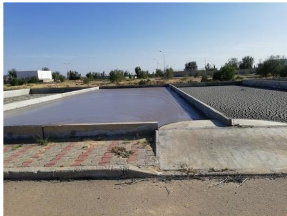
Figure 11 : Lits de séchage des boues
