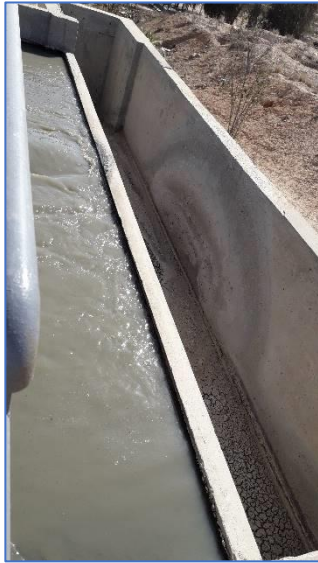
Figure 10 : Bypass eaux prétraitées
