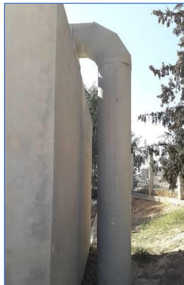
Figure 9 : Arrivée DN 500 depuis fosse de pompage
