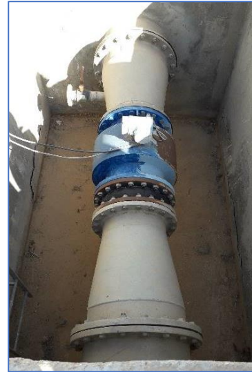
Figure 11 : Débitmètre Eaux Traitées
