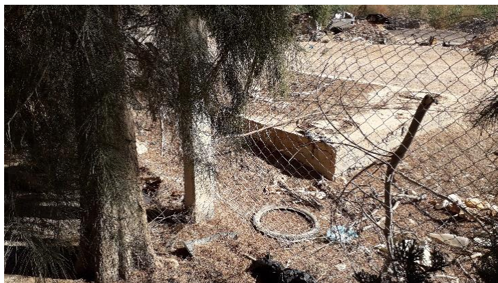
Figure 6 : Regard d'arrivée et de bypass, à l'extérieur de la STEP
