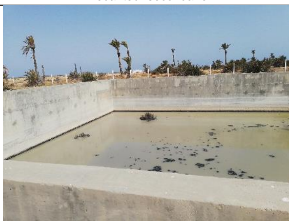
Bassin de stockage des eaux épurées
