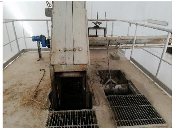
Système de dégrillage
