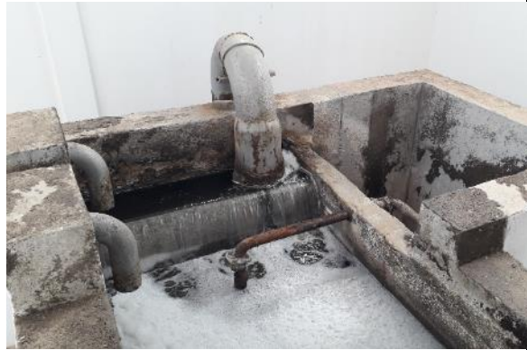
Arrivée de l'eau brute et déversoir de bypass général
