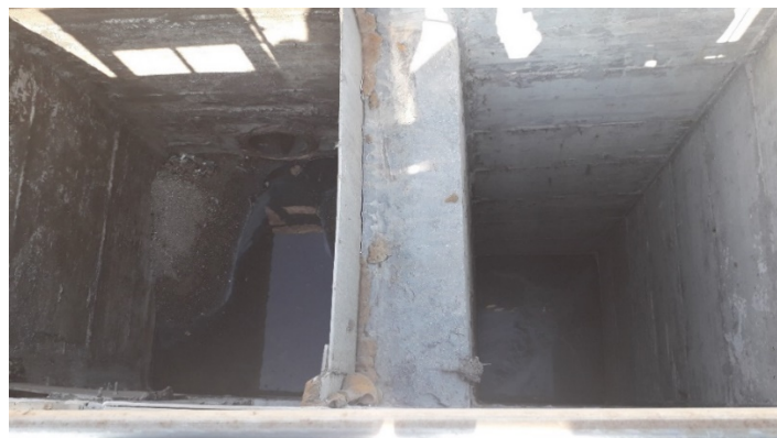
Bâche d'arrivée avec déversoir, nouveau prétraitement
