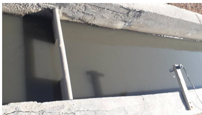
Débitmètre eau traitée
