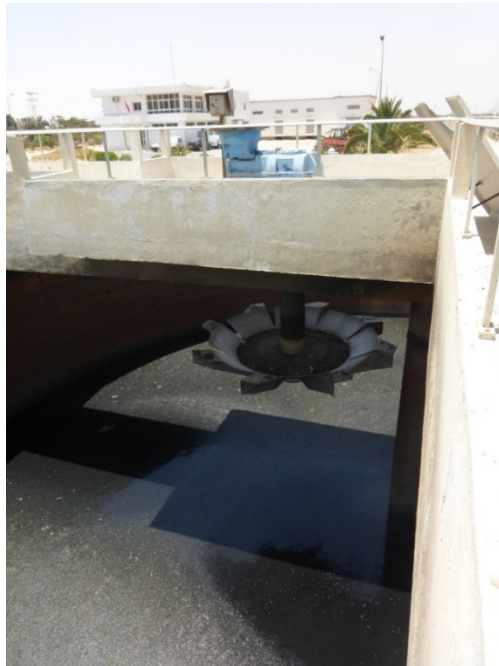
Figure 17. Vue des turbines de surface
