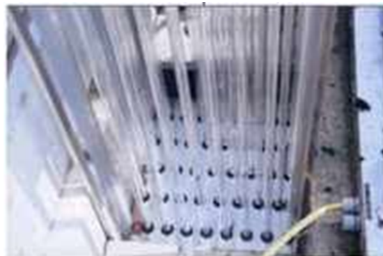
Figure 40 : Exemple de module de lampes verticales
