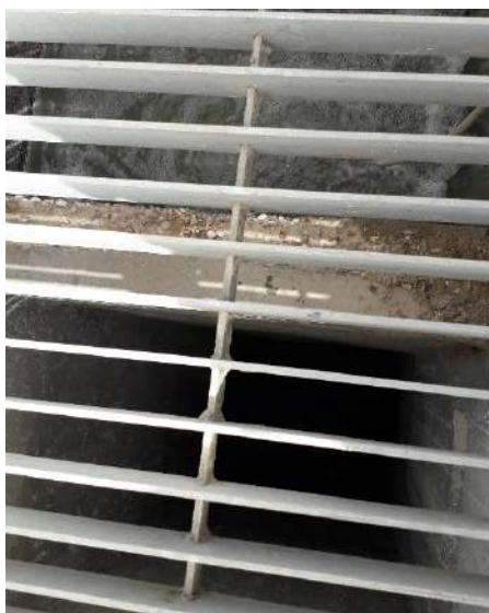
Déversoir de bypass eaux prétraitées
