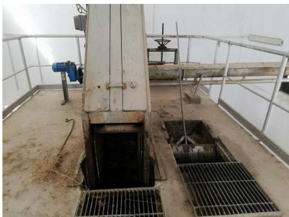
Système de dégrillage
