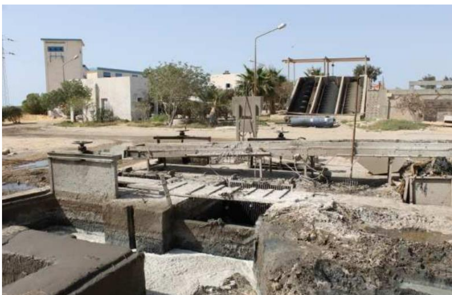
Poste de relevage
