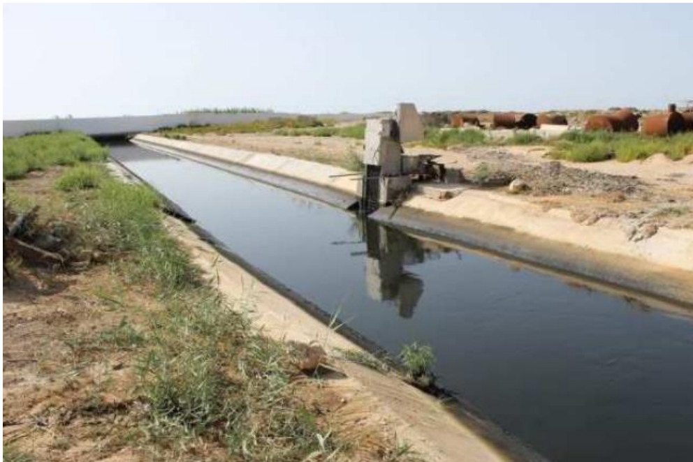
Canal de sortie
