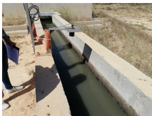
Canal de mesure de débit
